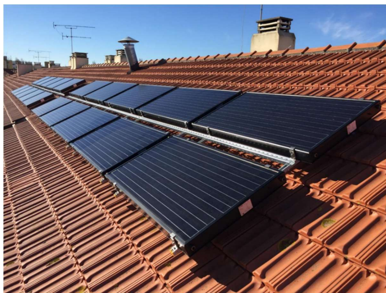
Figura 7 – Painéis solares híbridos atualmente instalados nº50
